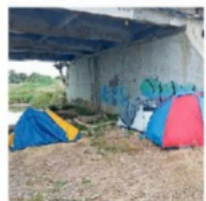
Le tende abusive sotto il ponte
